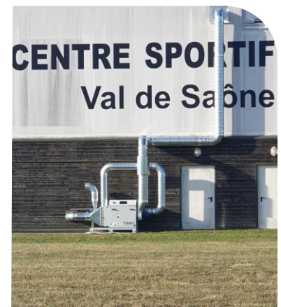
Déshydrateur du centre sportif
